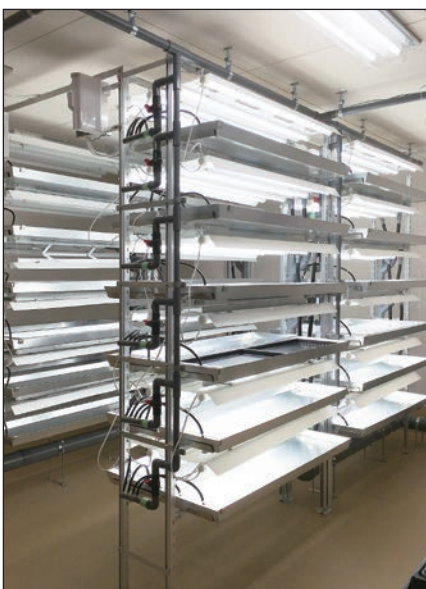
■ 育苗ユニット 多段式6段タイプ×6台 ※LED/FL：144灯
